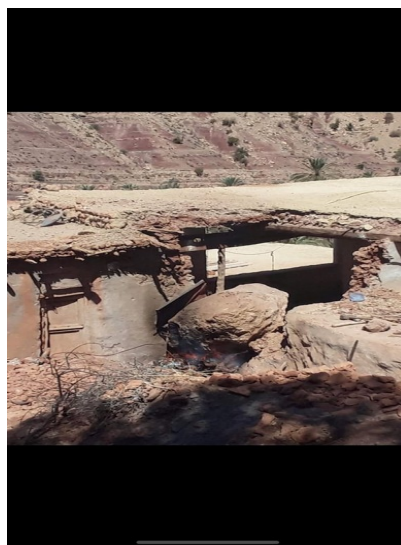
Haus, von einem herabfallenden Felsen getroffen
