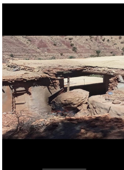
Vivienda golpeada por una roca
